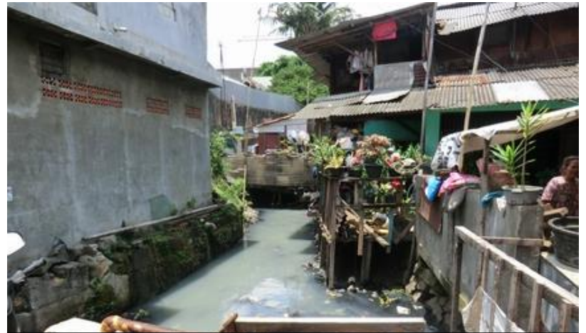
排水路の橋や建物の部分にゴミなどがつまり水が流れなくなる
